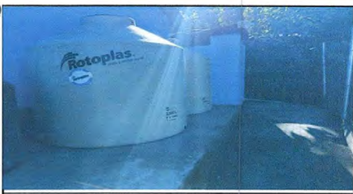
Foto 5: Tinacos de 2,500 litros en su base.
