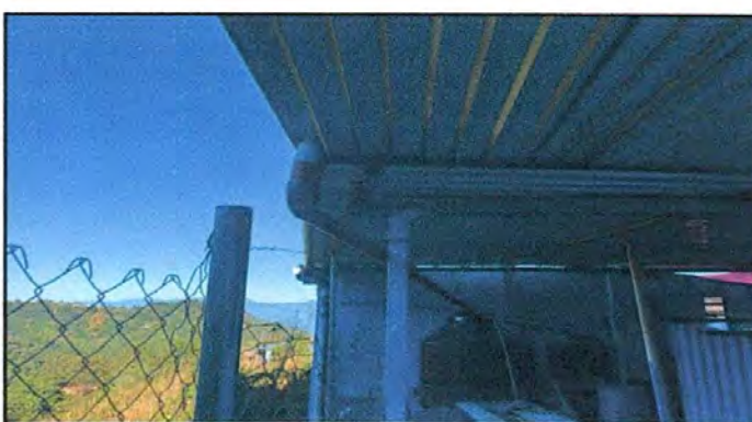
Foto 6: Calda de agua pluvial.
